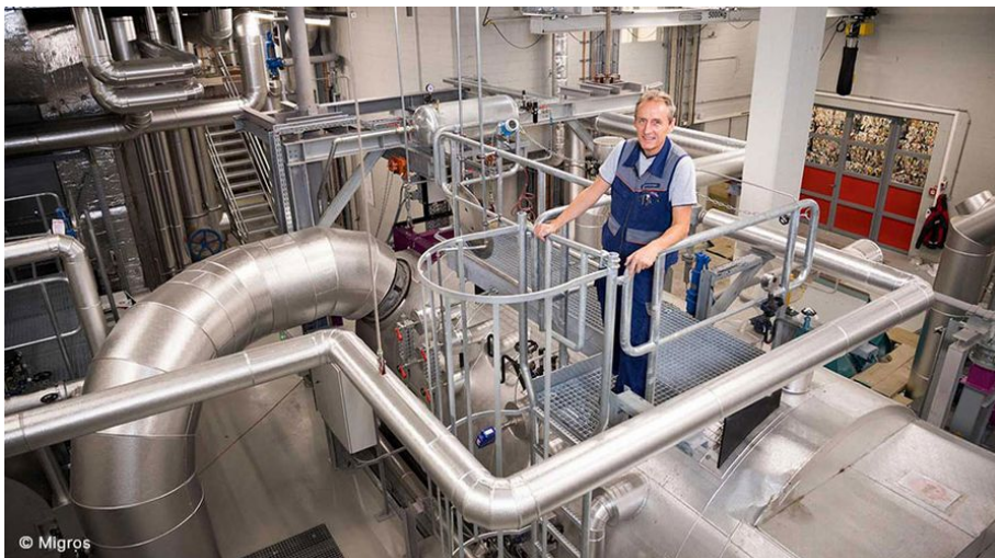
Der Projektleiter Josef Amrhein auf dem Hochdruck-Dampfkessel des Biomasse-Heizkraftwerks. © Migros
