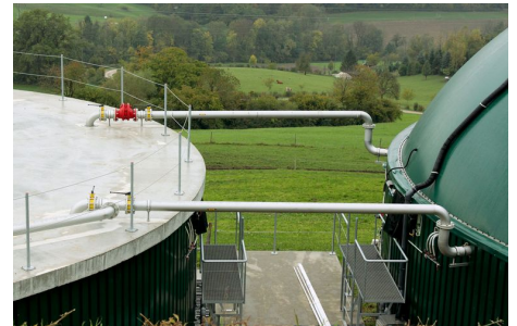
Ein Doppelmembran-Dach auf dem Gärtank und ein abgedecktes Endlager für die Gärreste garantieren, dass kein Methan entweicht (Foto: Klimastiftung Schweiz).
