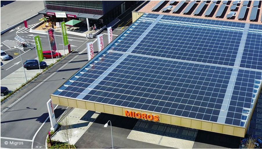
Photovoltaikanlage auf einer Migros-Parkplatzüberdachung. Foto: Migros
