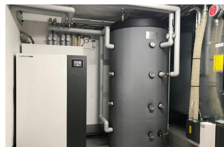
Pelletkessel (links) und Pufferspeicher (rechts) in einem Zweifamilienhaus. Foto: Bea Heizmann
