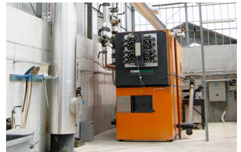
1'600 Kilowatt Holzkessel in einem Gewächshaus der BioLand Agrarprodukte AG in Steinmaur ZH. Foto: Daniel Meier
