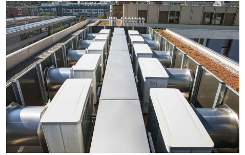
Luftwärmepumpen auf dem Dach ermöglichen die Einhaltung der Schallemissionen auch in der Stadt. Copyright: Stiebel Eltron, Fotografie: Eliane Dürst
