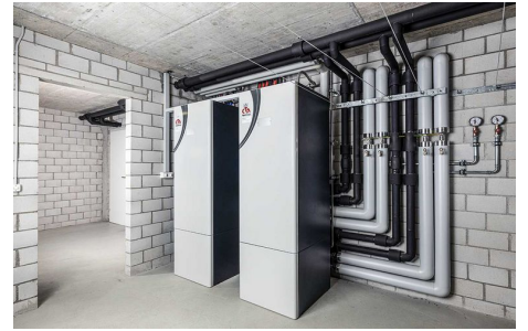
Durch die Reihung in einer Kaskade können Wärmepumpen-Anlagen auch sehr hohe Wärmeleistungen für Mehrfamilienhäuser erreichen. Copyright: CTA AG, Fotografie: Reto Andreoli
