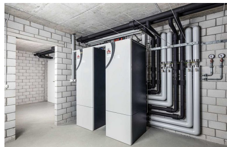
Durch die Reihung in einer Kaskade können Wärmepumpen-Anlagen auch sehr hohe Wärmeleistungen für Mehrfamilienhäuser erreichen. Copyright: CTA AG, Fotografie: Reto Andreoli
