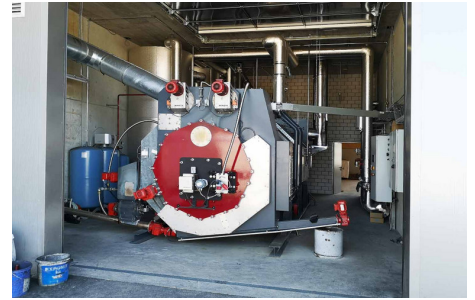
Pyrolyse-Anlage zur Herstellung von Pflanzenkohle (Foto und Copyright: Peter Fröhlich)
