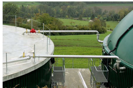
Un toit à double membrane couvrant la cuve de méthanisation, ainsi qu'une aire fermée de stockage du digestat, garantissent une étanchéité totale évitant toute émanation de méthane dans l'atmosphère.
