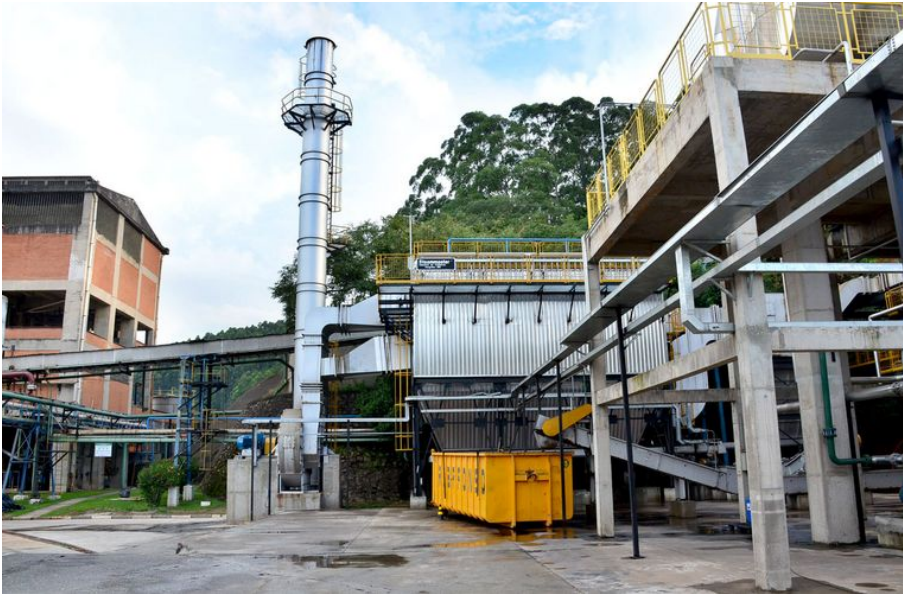
Chaudière à biomasse de Improvements Papers dans son usine de pâtes et papiers à Caieiras, Sao Paulo, Brésil.
