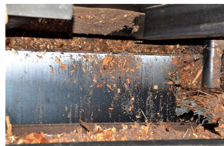
Point d'entrée de la biomasse mélangée dans la chaudière à biomasse.
