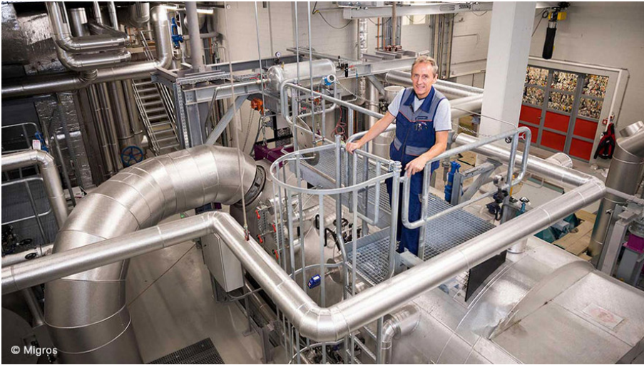
Chef de projet Josef Amrhein sur la chaudière à vapeur haute pression de la centrale thermique à biomasse. © Migros
