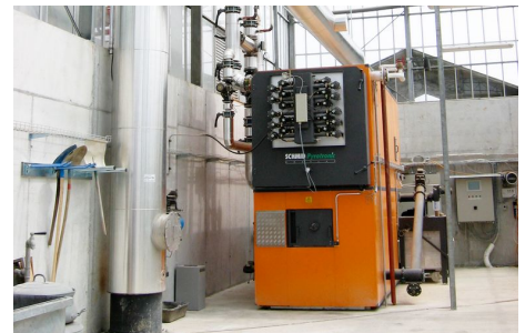
Chauffage au bois avec une puissance de 1'600 kilowatts dans une serre de l'exploitation BioLand Agrarprodukte à Steinmaur ZH. Photo: Daniel Meier
