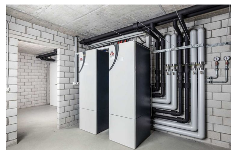
Grâce à une installation en cascade, les installations à pompe à chaleur peuvent aussi atteindre une puissance thermique très élevée pour les immeubles locatifs. Copyright: CTA AG, Photographie: Reto Andreoli
