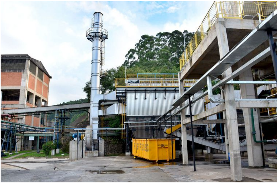
Chaudière à biomasse de Improvements Papers dans son usine de pâtes et papiers à Caieiras, Sao Paulo, Brésil.
