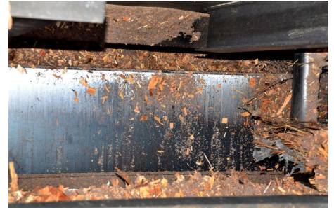
Point d'entrée de la biomasse mélangée dans la chaudière à biomasse.
