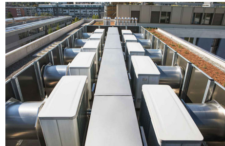
Le pompe di calore ad aria posizionate sul tetto consentono di rispettare i livelli di emissione sonora anche in città. Copyright: Stiebel Eltron, fotografia: Eliane Dürst
