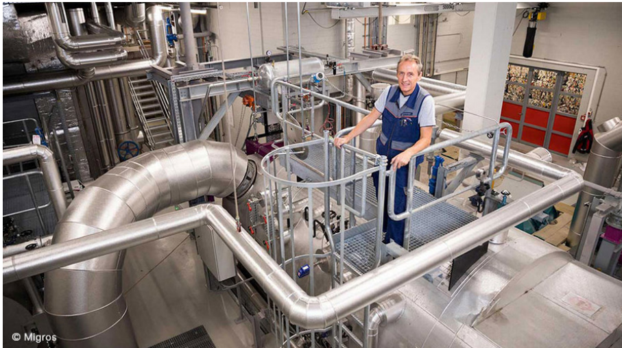
Il responsabile di progetto Josef Amrhein sulla caldaia a vapore ad alta pressione della centrale elettrica a biomassa. © Migros
