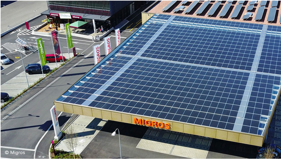
Impianto fotovoltaico su un tetto di un parcheggio Migros. Foto: Migros
