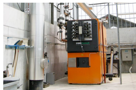
Caldaia a legna da 1 600 kilowatt in una serra di BioLand Agrarprodukte SA a Steinmaur ZH. Foto: Daniel Meier
