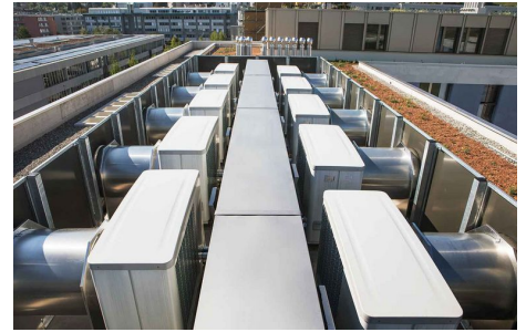
Le pompe di calore ad aria posizionate sul tetto consentono di rispettare i livelli di emissione sonora anche in città. Copyright: Stiebel Eltron, fotografia: Eliane Dürst
