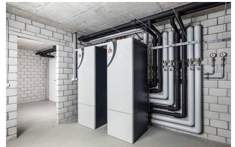
Mediante la disposizione a cascata, gli impianti di pompa di calore possono raggiungere anche prestazioni termiche molto elevate per case plurifamiliari. Copyright: CTA SA, Fotografia: Reto Andreoli
