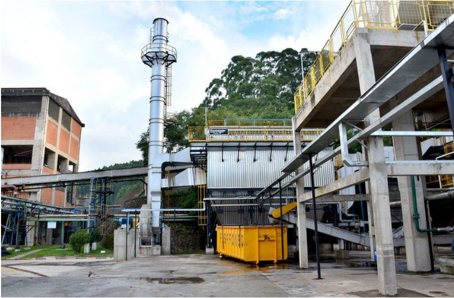
Caldaia a biomassa di Melhoramentos Papei nella fabbrica di cellulosa e carta a Caeiras, San Paolo, Brasile.
